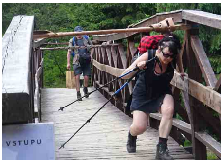
Dřevěná konstrukce mostu po 15 letech služby v drsných podmínkách již přestala být bezpečná, foto Josef Joe Kuna
