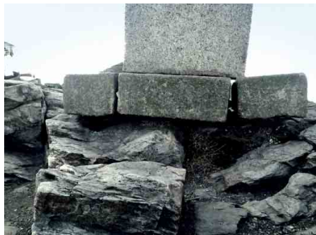
Základy pod kamenem byly již na první pohled nestabilní
