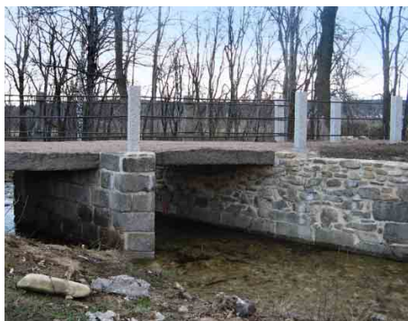
Po povodni v roce 2010 byl most opraven
